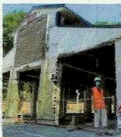
CESSATA ATTIVITÀ Ora in condizione di degrado
